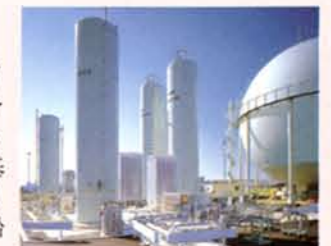
LNG衛星基地
